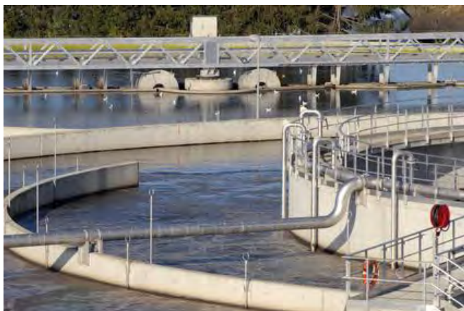
Station d'épuration (Fotolia)
