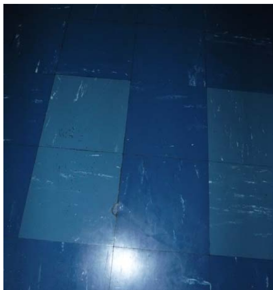
Illustration 11 : Dalle de sol vinyle amiante (Crédit : LAFP)
