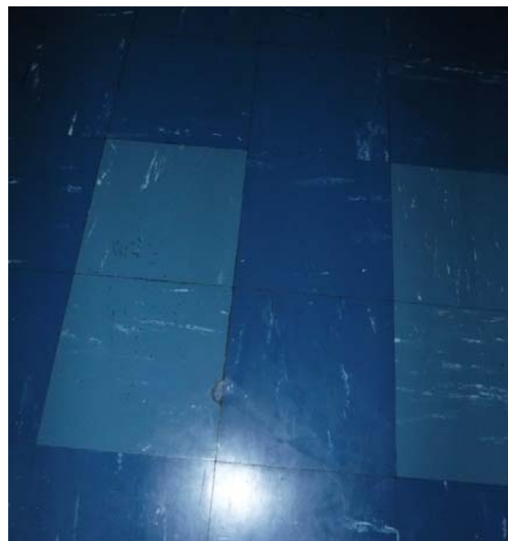
Illustration 11 : Dalle de sol vinyle amiante (Crédit : LAFP)
