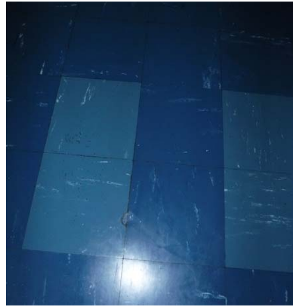
Illustration 11 : Dalle de sol vinyle amiante (Crédit : LAFP)
